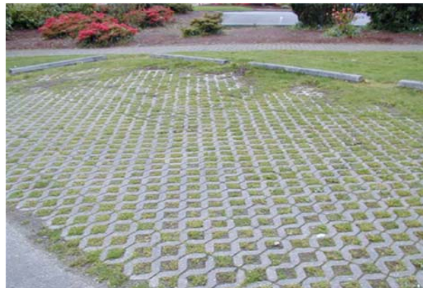
Figura 301. Pavimento permeável em estacionamento
