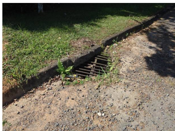
Figura 212. Boca de lobo existente no município de Monte Alegre do Sul
