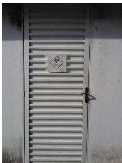
Figura 257. Deposito de Resíduos de Sólidos de Saúde
