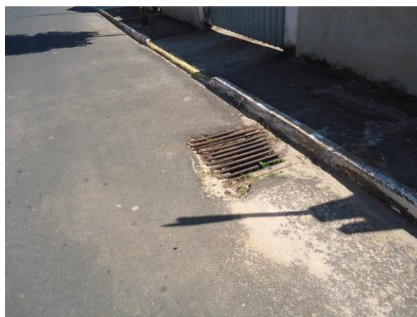
Figura 208. Boca de lobo existente no município de Monte Alegre do Sul
