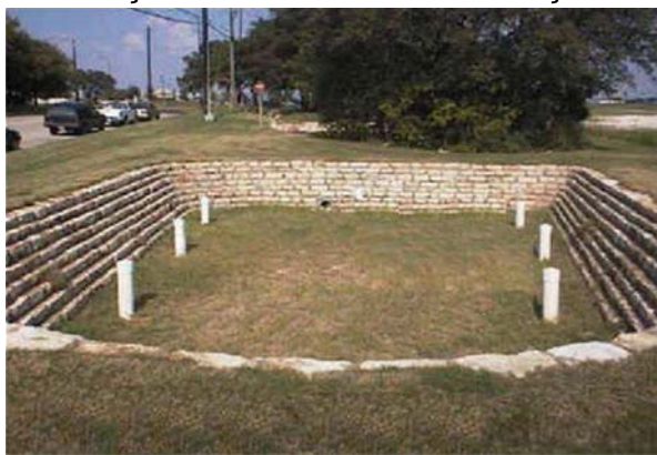
Figura 307. Pequeno reservatório de detenção
