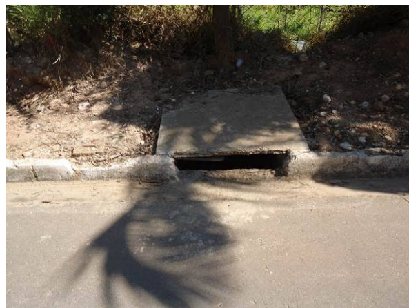
Figura 210. Boca de lobo existente no município de Monte Alegre do Sul
