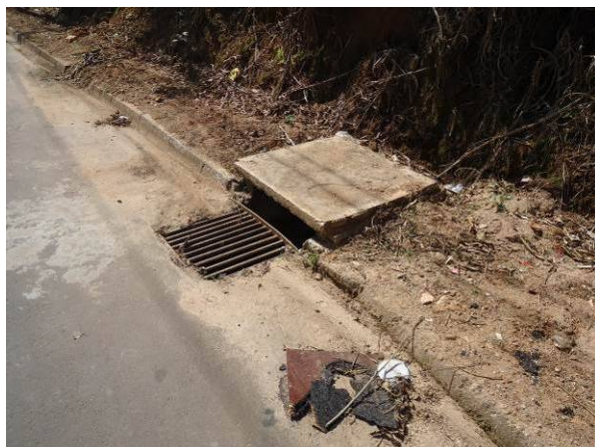
Figura 209. Boca de lobo existente no município de Monte Alegre do Sul
