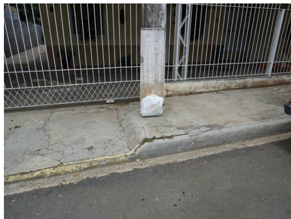
Figura 242. Disposição inadequada dos resíduos
