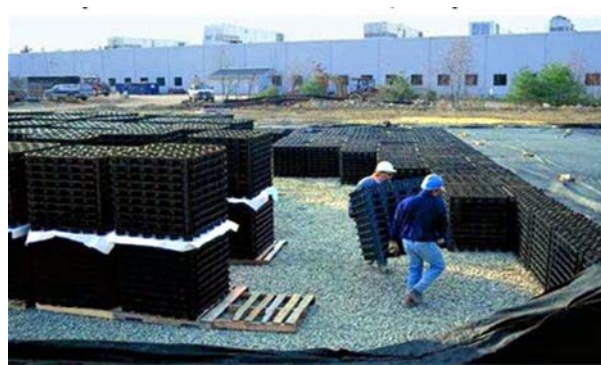
Figura 314.. Reservatório de retenção enterrado
