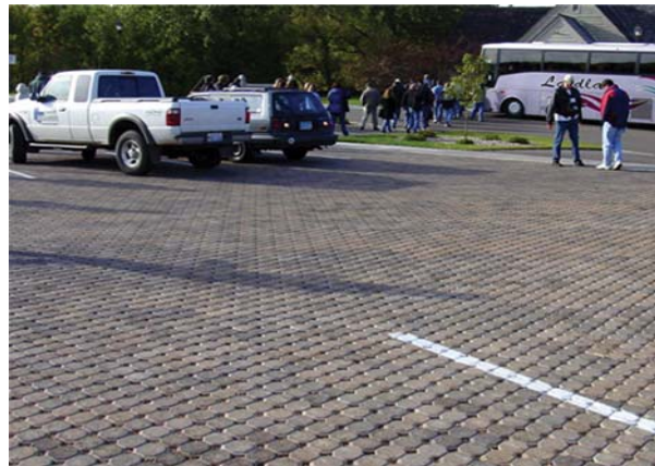
Figura 303. Pavimento permeável em estacionamento
