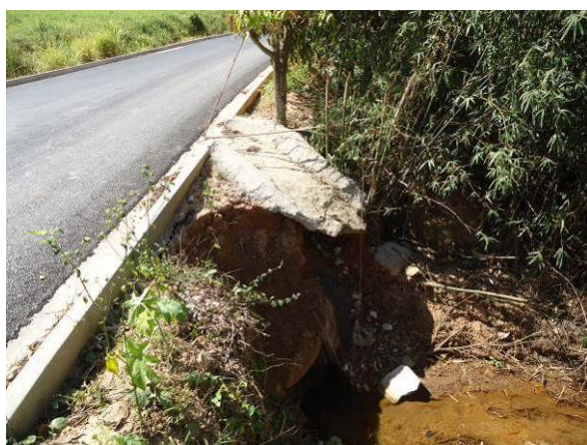
Figura 211. Canaleta de Águas Pluviais existentes no município de Monte Alegre do Sul
