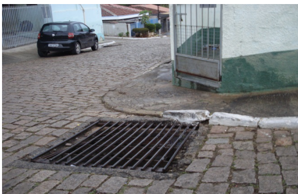
Foto 4-45: Exemplo de boca de lobo em via com pavimentação em paralelepípedo.
